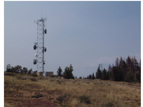
Bruin Point Repeater Site
